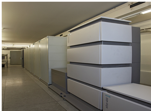
Abbildung 4: Telefonie-Switch der ID-KOM
